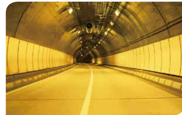
隧道灯示范工程
